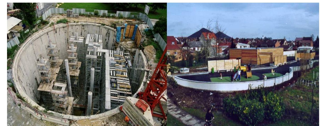
Exemplo dun tanque de retención soterrado e cun uso recreativo na superficie
