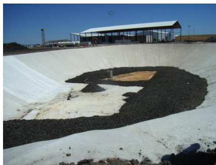
Figura 56 Deposito de almacenamiento de agua realizado con NFU.
