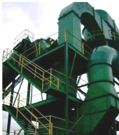
Figura 28 Conductos aspiración residuo ligero. Fuente: FER
