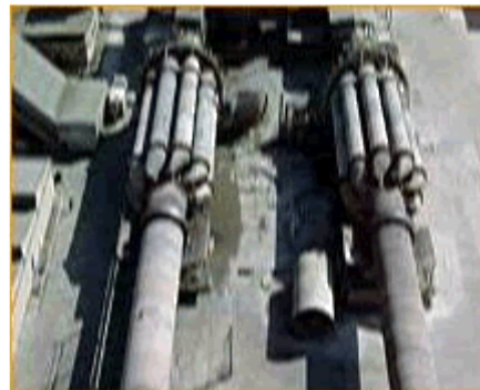
Vista exterior de enfriadores satélites
